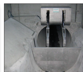
Nagyméretű szennyvíz-csatorna öblítő
