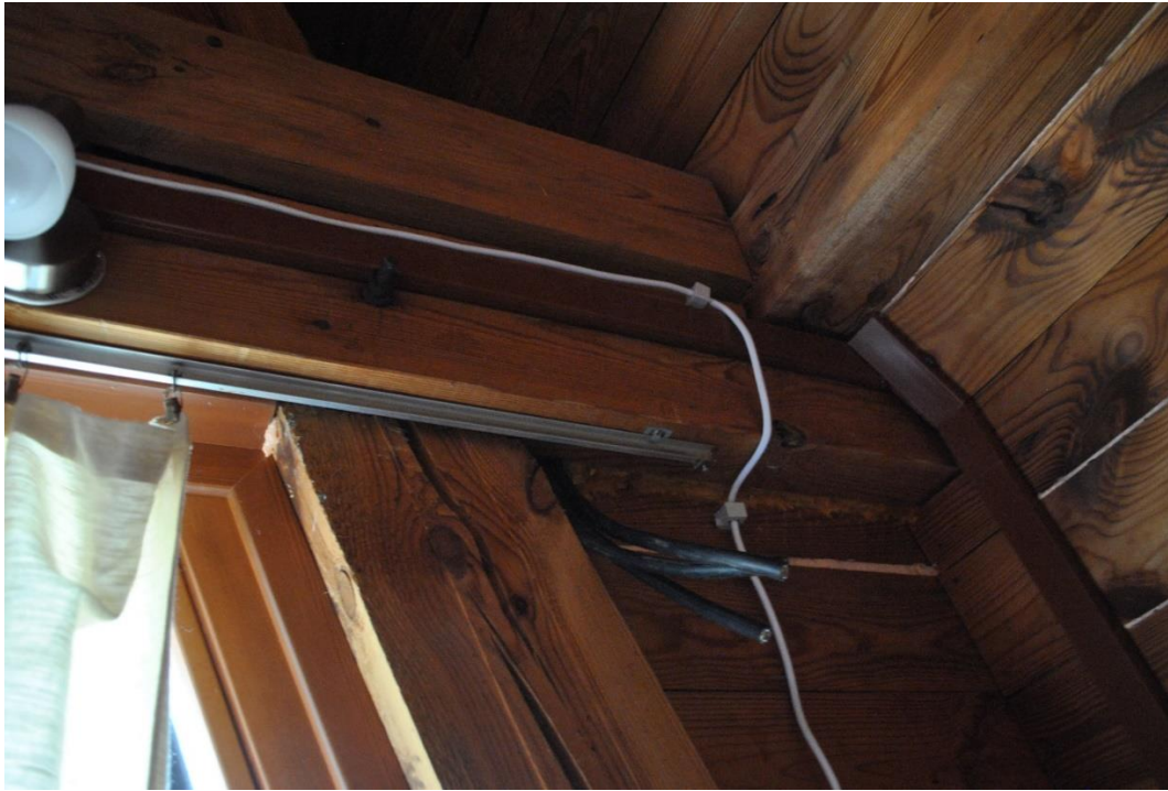
A régi vezeték még kilóg, de elvágva, az új a barna vezetékcsatorna alatt húzódik.
