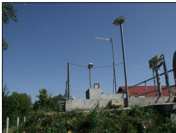
Térvilágítás és URH jelátviteli állomás
